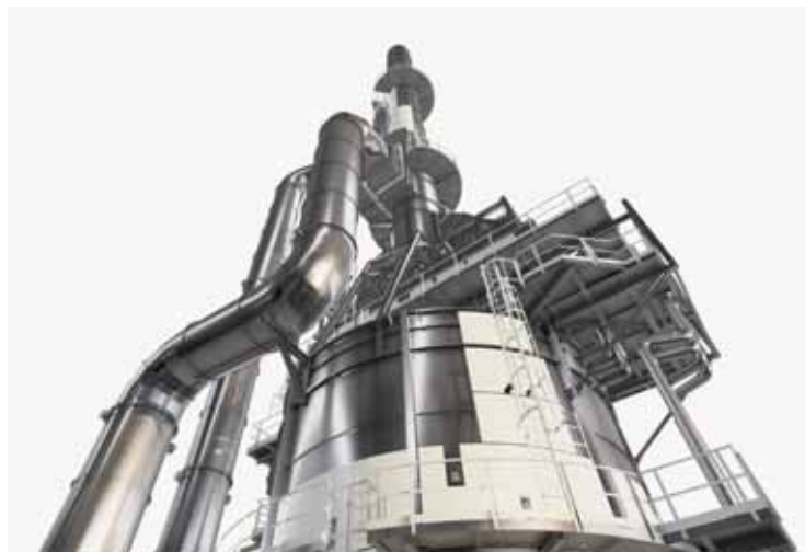
Fig. 2 - Forno di processo raffineria Midor
