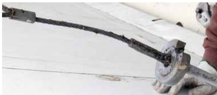
Fig. 10 - Tirante privo di corrosione a destra, e pressoché corroso nel tratto a sinistra. Il tirante, fatto di fili di diametro di pochi mm, è particolarmente sensibile alla corrosione. Sono stati sostituiti con tiranti in acciaio inox.
