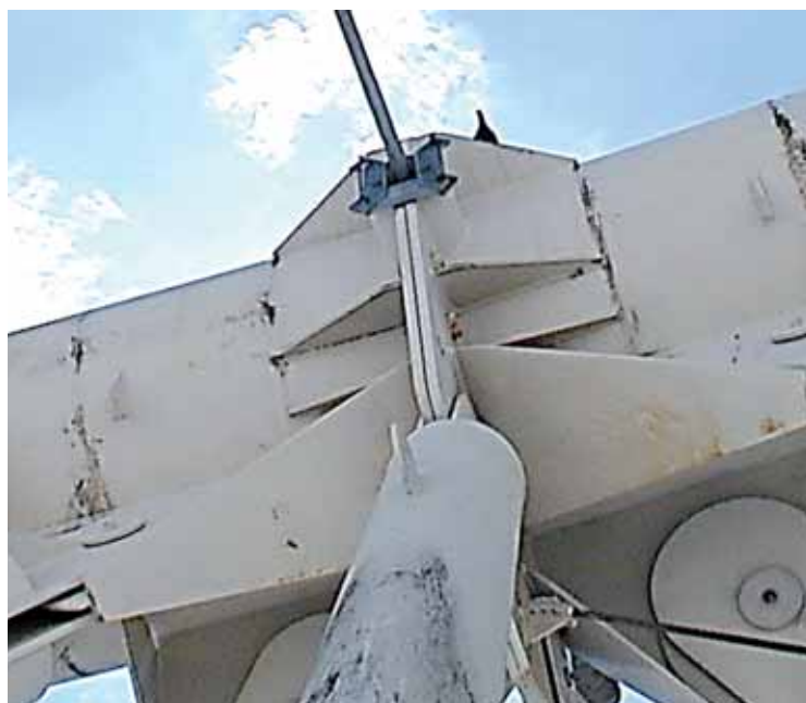
Fig. 8 - Piccione in vista in prossimità alla sede dell'ancoraggio di una fune portante. Nel tempo le sedi sono divenute nidi di piccioni.
