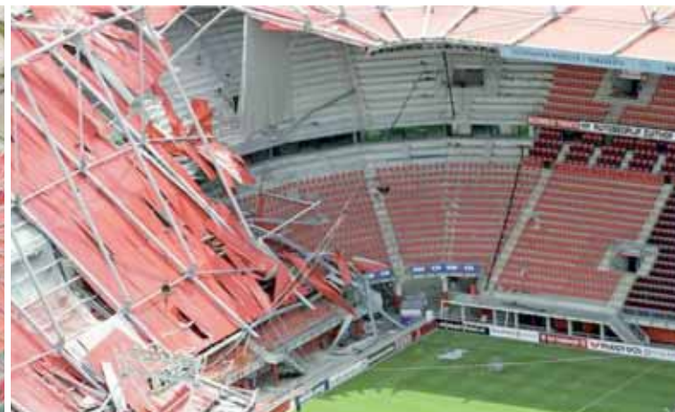
Fig. 5 - Il 7 luglio 2011 è crollata una parte del tetto dello stadio mentre era in fase di ristrutturazione. La struttura, nella configurazione finale, era redundant. Tuttavia nel corso della costruzione, parti della struttura erano in condizioni di mensola pressoché isostatica. La redundancy è bene sia presente prevedendo anche le fasi temporanee di costruzione.
