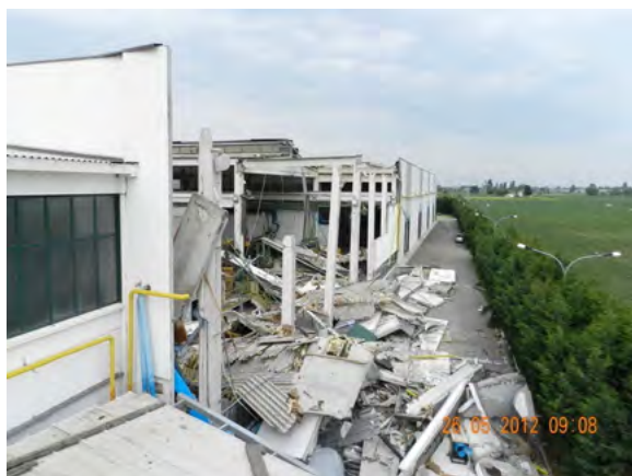
Fig. 12 - Terremoti del 20 e 29 maggio 2012 nella bassa modenese: ribaltamento dei tamponamenti di facciata e della copertura in capannoni a Dosso di Sant'Agostino (Ferrara) (Atlante, Centro e Nord, pag. 642, in Tralli, 2023). La maggioranza dei capannoni della zona sono stati progettati prima che la bassa modenese fosse inserita nella normativa antisismica.
